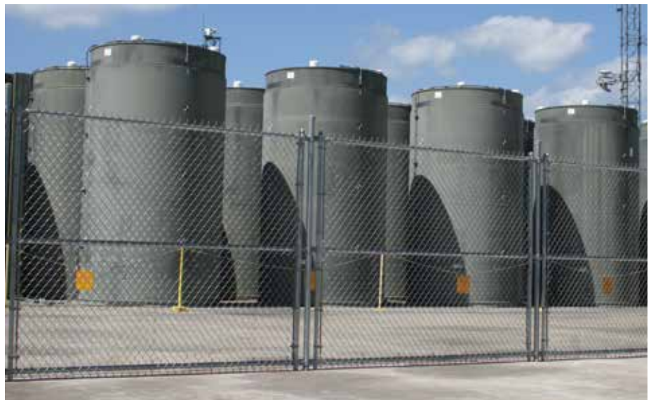
圖二、美國緬因·洋基 (Maine Yankee) 核電廠已啟用的乾式貯存設施。圖片來源：World Nuclear Association 網站
