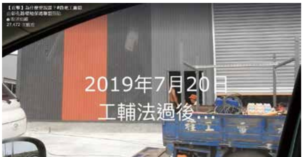
圖三、本會在 2019 年 7 月 20 日現勘卻發現電表電箱並未拆除，且有工人能夠接電進行施工。
